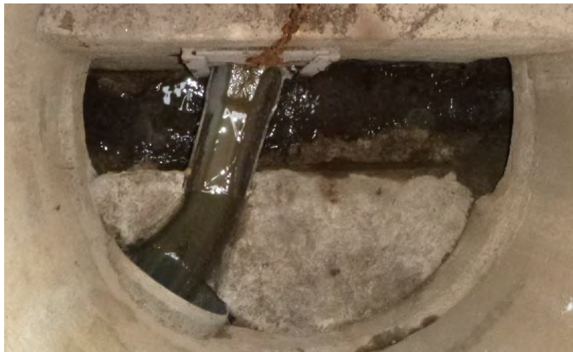
Déversoir d'orage rue des écoles
