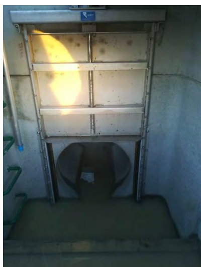
Vanne de confinement en sortie
