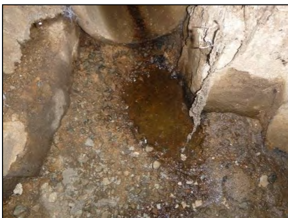
Absence de cunette id 3064
